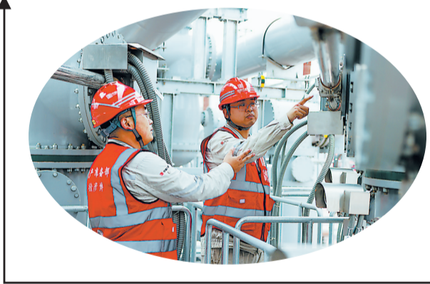
大唐郓城630°C国家电力示范项目1号机组反送电一次成功
