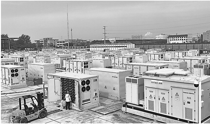
菏泽普元200MW/400MWh独立储能电站一角。
